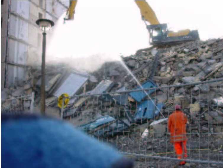
Bild 15: Wasserspritzer im Bodenbereich zur Staub- und Faserbindung - ohne vorschriftsmäßige Benutzung des Schutzhelms
